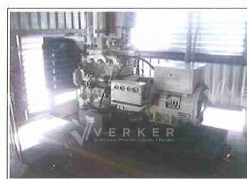
FOTO 27 PLANTA DE EMERGENCIA EN AZOTEA
