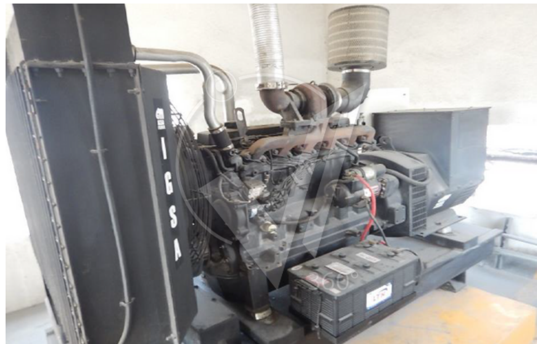
PLANTA DE EMERGENCIA
