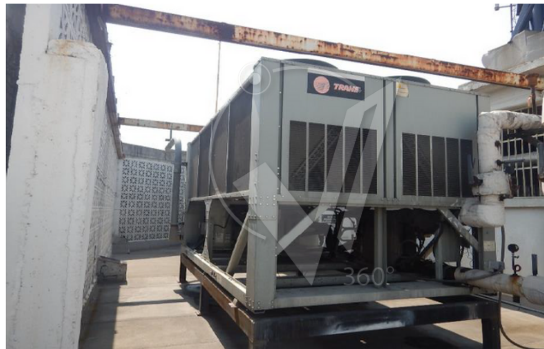
CHILLER TRANE DE 120 TONELADAS
