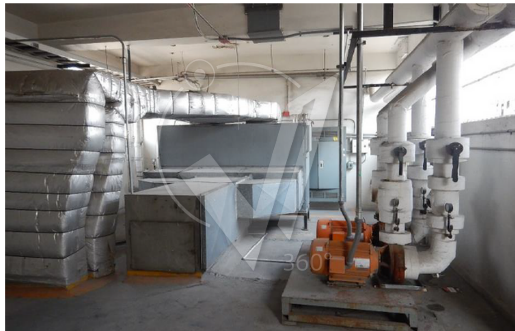
MANEJADORA DE AIRE EN AZOTEA
