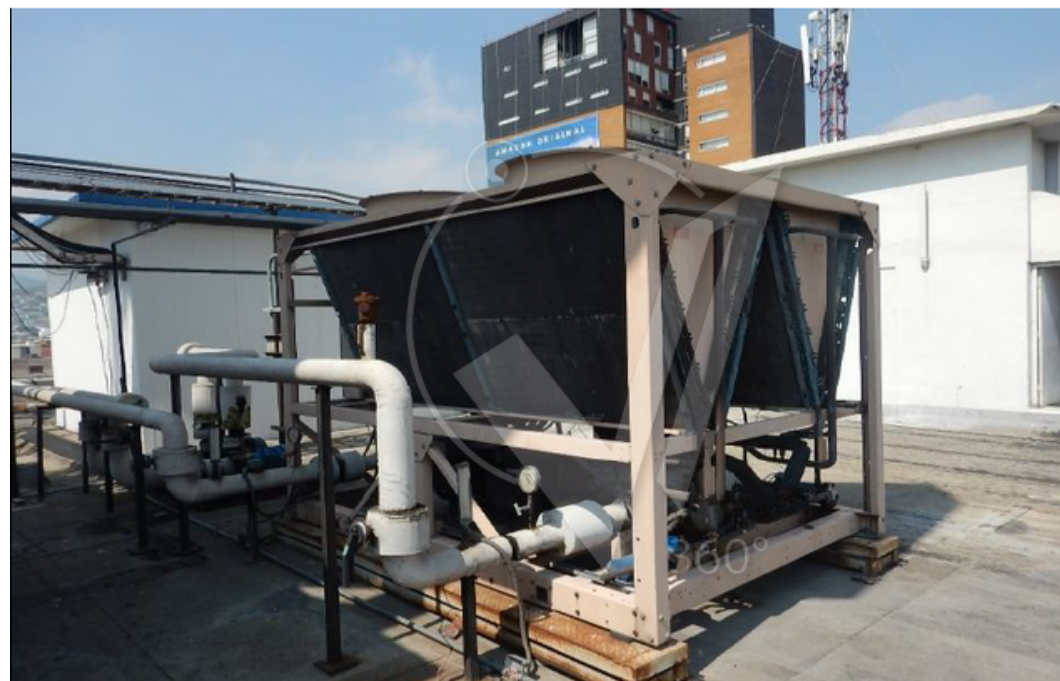
CHILLER YORK DE 60 TONELADAS
